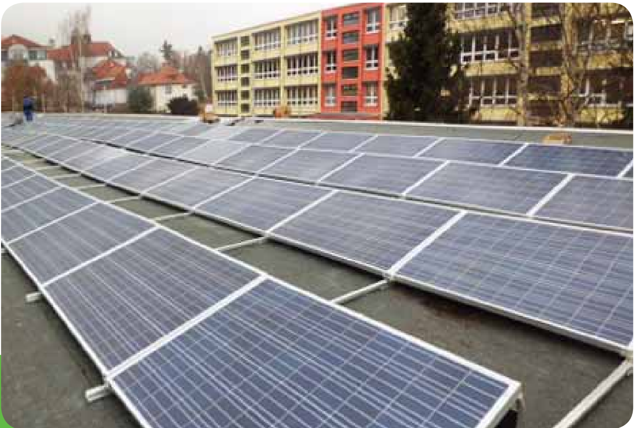
Photovoltaikanlage auf dem Dach der Kita Bleicherode
