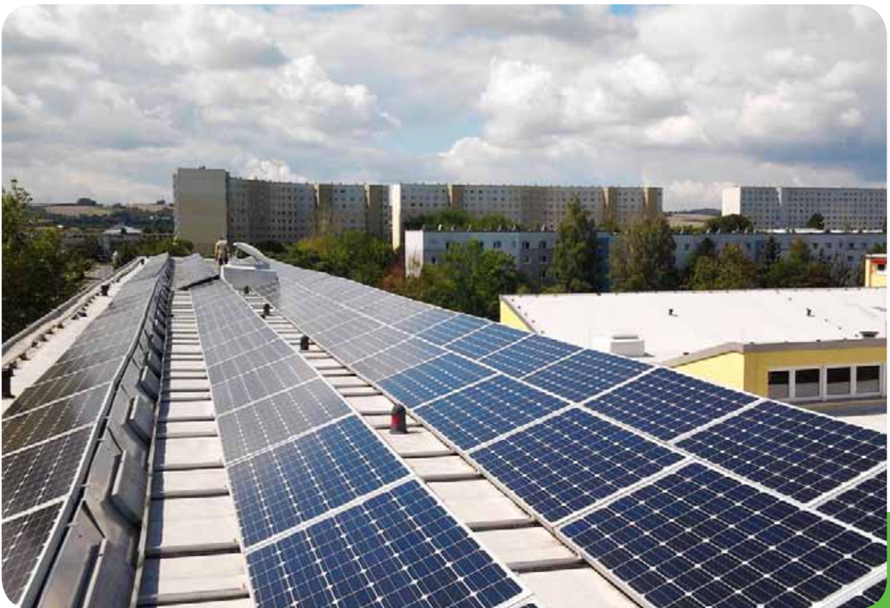
Photovoltaik-Anlage der E3G auf dem Dach einer Erfurter Schule in der Bukarester Straße
