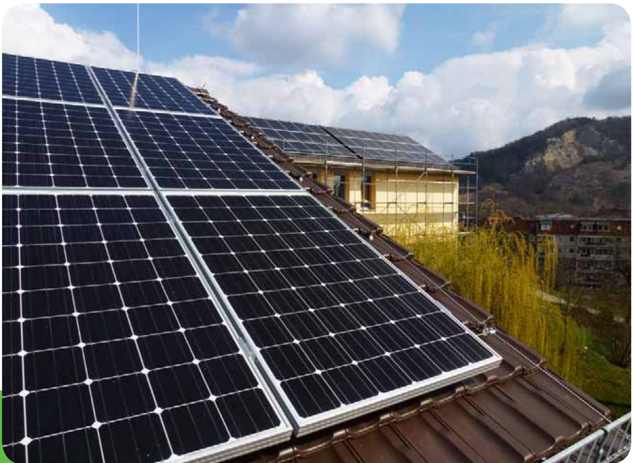
Photovoltaikanlage auf dem Dach der Grundschule „Friedensschule“ Kahla
